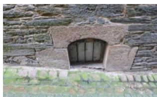
Ouverture de cave obstruée
