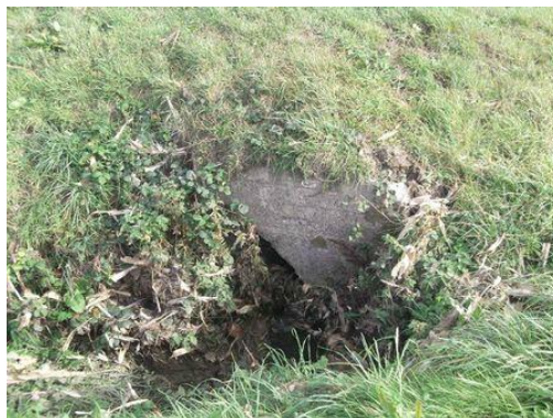
Débris de béton visible dans le fossé
